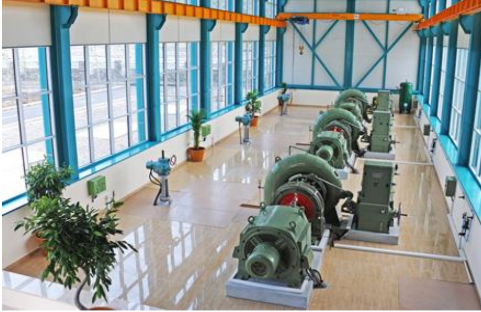
Şəkil 7. KSES-in turbin zalının ümumi görünüşü
